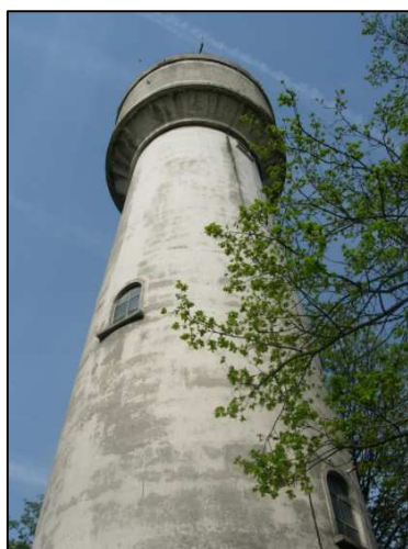
Réservoir de Boisemont 75m 3
