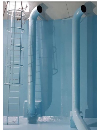
Etanchéité interne cuve n°2 Boisemont 2x4000m 3
